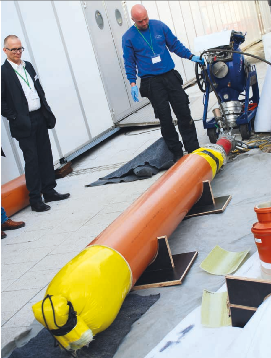
Am Rande des Lindauer Seminars führte Bluelight Prototypen der neuen Produkte praktisch vor. Der GFK-Liner DN 300 mit einer Wandstärke von 4 Millimetern wurde mit einer Geschwindigkeit von 1,65 Metern pro Minute, entsprechend 100 Metern pro Stunde ausgehärtet.
